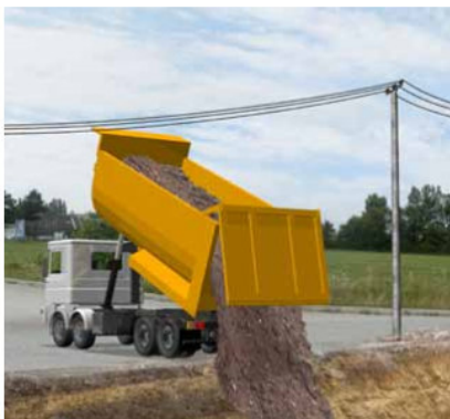
Gefährliche Arbeiten finden sich auf der Baustelle ...
